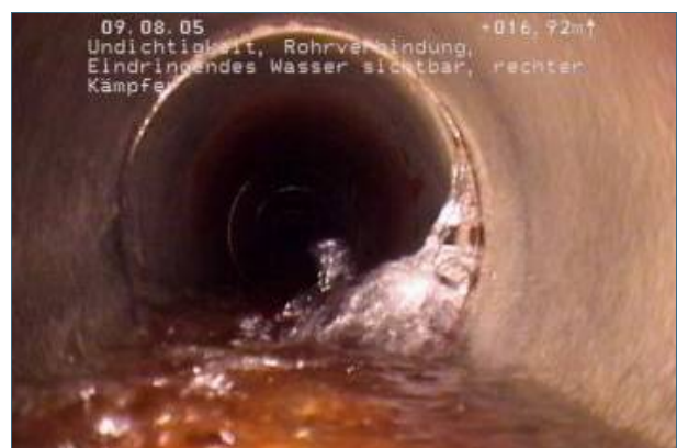
Abb. 4: Wenn aber Grundwasser in die Leitung eindringt, muss schnell gehandelt werden. Hier ist die Sanierungspriorität sehr hoch.
